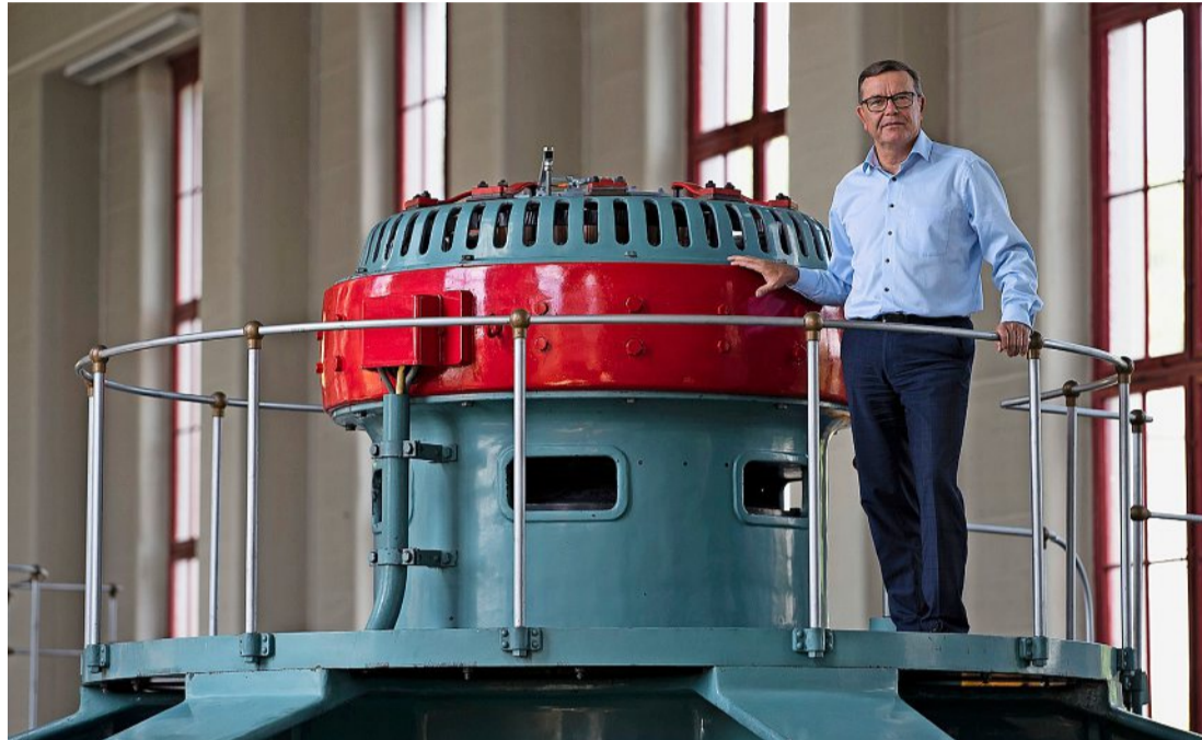
Zweifache Rückkehr zu den Wurzeln: Walter Wirth im Turbinensaal des Kraftwerks Schwarzhäusern. Foto: chp
